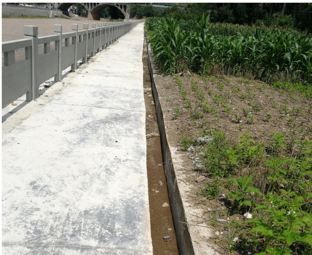
右岸堤后排水沟（2021.8）
